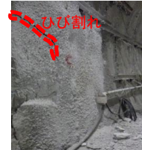
吹付けコンクリートのひび割れ
