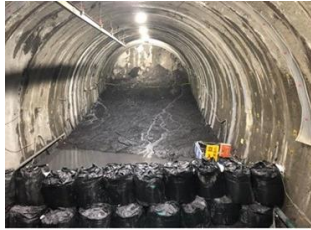
トンネル坑内土砂流入状況
