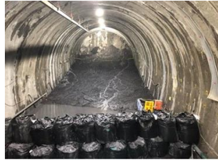
トンネル坑内土砂流入状況
