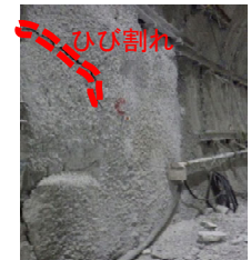
吹付けコンクリートのひび割れ
