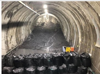
トンネル坑内土砂流入状況
