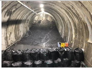
トンネル坑内土砂流入状況
