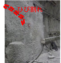
吹付けコンクリートのひび割れ
