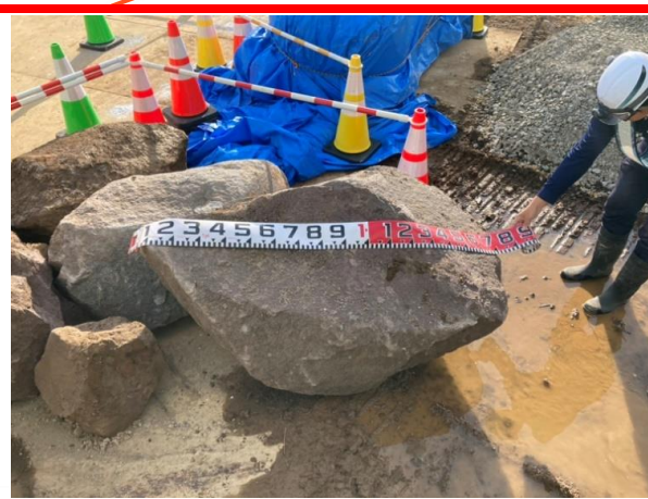
撤去された岩塊
