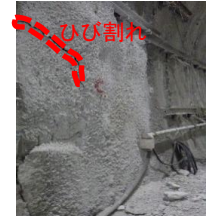
吹付けコンクリートのひび割れ
