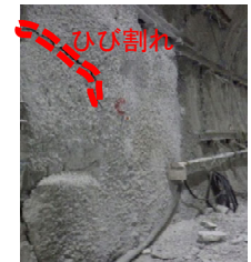
吹付けコンクリートのひび割れ
