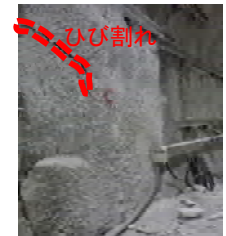
吹付けコンクリートのひび割れ
