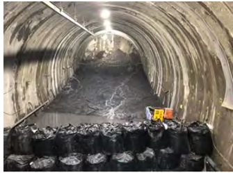
トンネル坑内土砂流入状況
