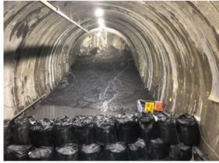
トンネル坑内土砂流入状況
