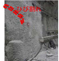
吹付けコンクリートのひび割れ
