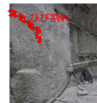
吹付けコンクリートのひび割れ
