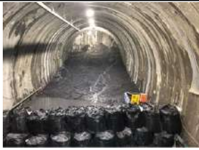
トンネル坑内土砂流入状況
