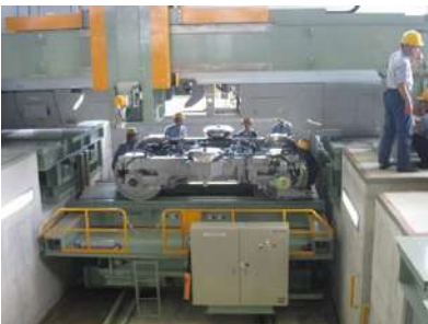
②台車抜取装置
