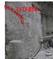
吹付けコンクリートのひび割れ
