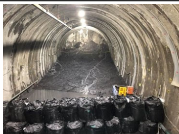
トンネル坑内土砂流入状況
