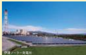
伊達ソーラー発電所
